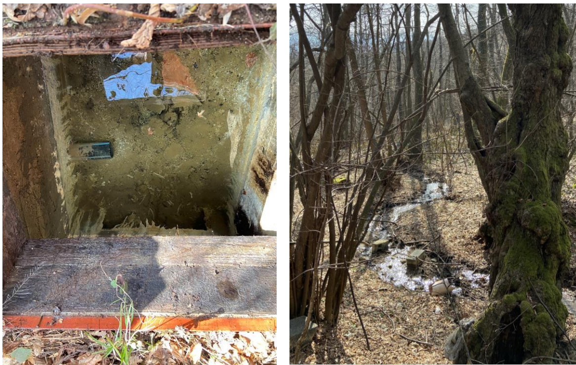
Slika IV-10: Kaptaža izvorišta Lovačka kuća i potok u neposrednoj blizini
